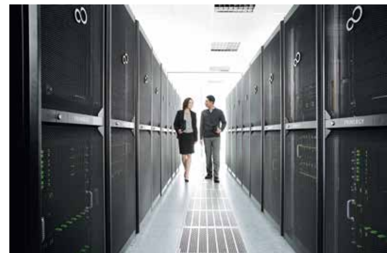
富士通数据中心服务 Fujitsu Data Center Services
