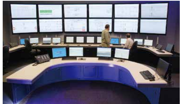
西屋 AP1000 主控室模拟机房 Westinghouse AP1000 Main Control Room - Simulator
